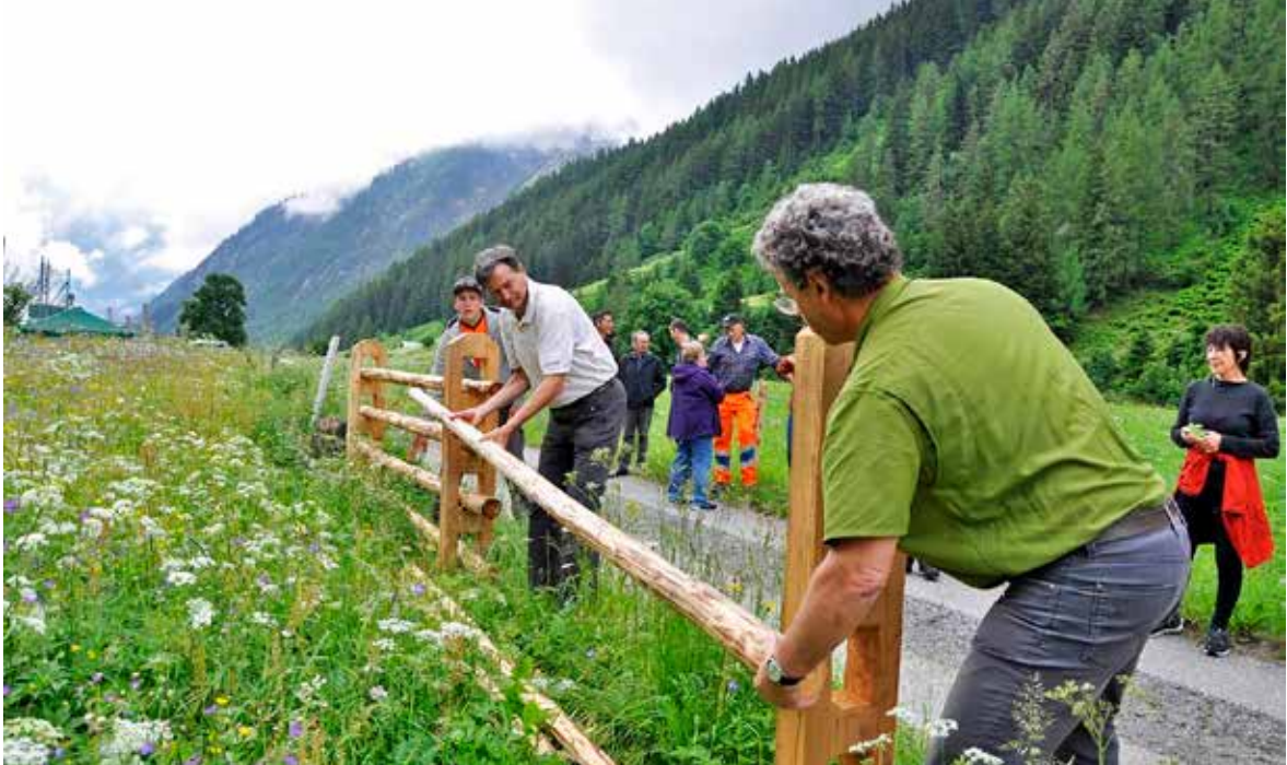
Fertig gebaut: neuer Holzzaun made in Meiental (Foto: Pia Tresch) / Mission réussie: une nouvelle clôture en bois made in Meiental / Costruzione terminata: nuova recinzione in legno «made in Meiental»
