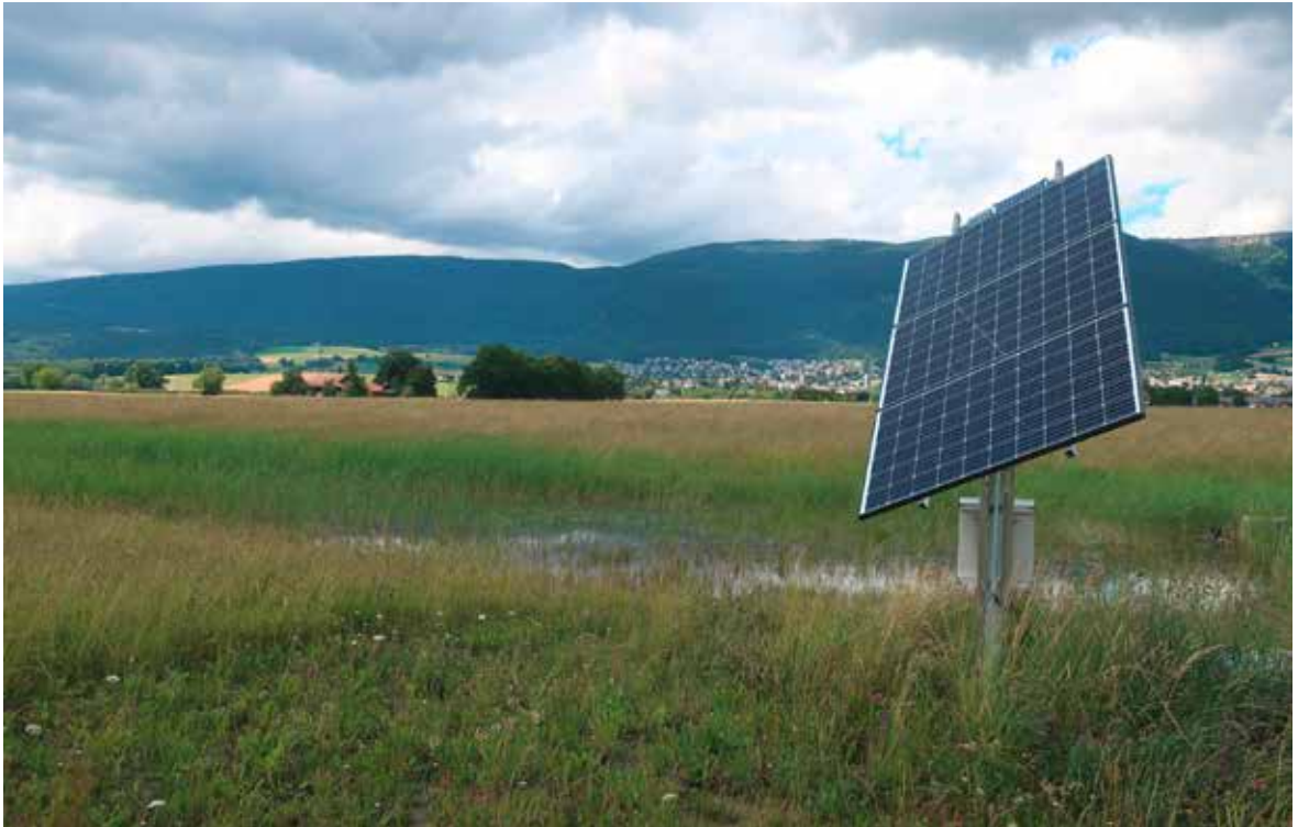
Eine mit Solarpanel betriebene Grundwasserpumpe reguliert den Wasserstand im Tümpel Ostportal.
