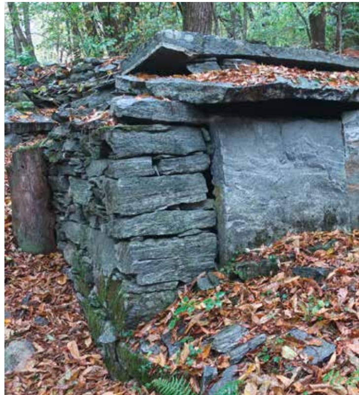
Questa costruzione arcaica in sassi e piode in passato era utilizzata come laboratorio artigianale dal leggendario scalpellino Tóni Tolátt. In qualità di elemento del nuovo progetto di valorizzazione del paesaggio, il Patriziato Avegno intende conservare questo manufatto quale testimonianza di questo tipo di artigianato.
