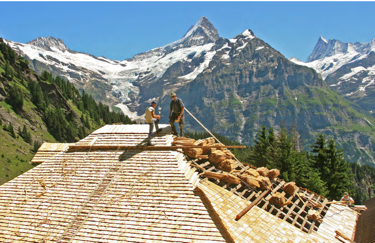
Erneuerung eines Schindeldachs in Grindelwald (BE), mit Blick aufs Wetterhorn: Zum Erhalt der Schindelkultur unterstützt der FLS für einmal auch eine Studie.
