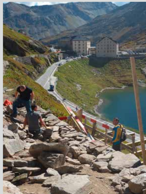
Réfection du mur de pierre sèche de la Promenade des Chanoines, Col du Grand Saint-Bernard, VS
