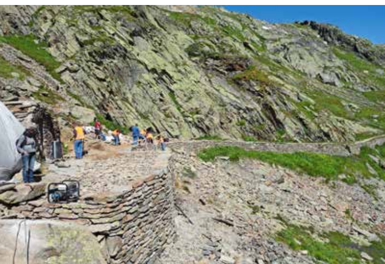
Travaux à 2500 m d'altitude: le chantier ne peut s'ouvrir que durant l'été.
