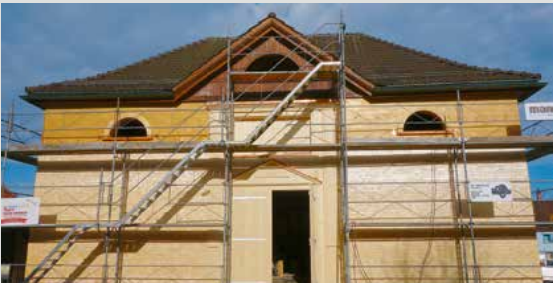
Prägend für die Appenzeller Streusiedlungs-Landschaft: Renovation des Schindelschirms eines Hauses in AI
