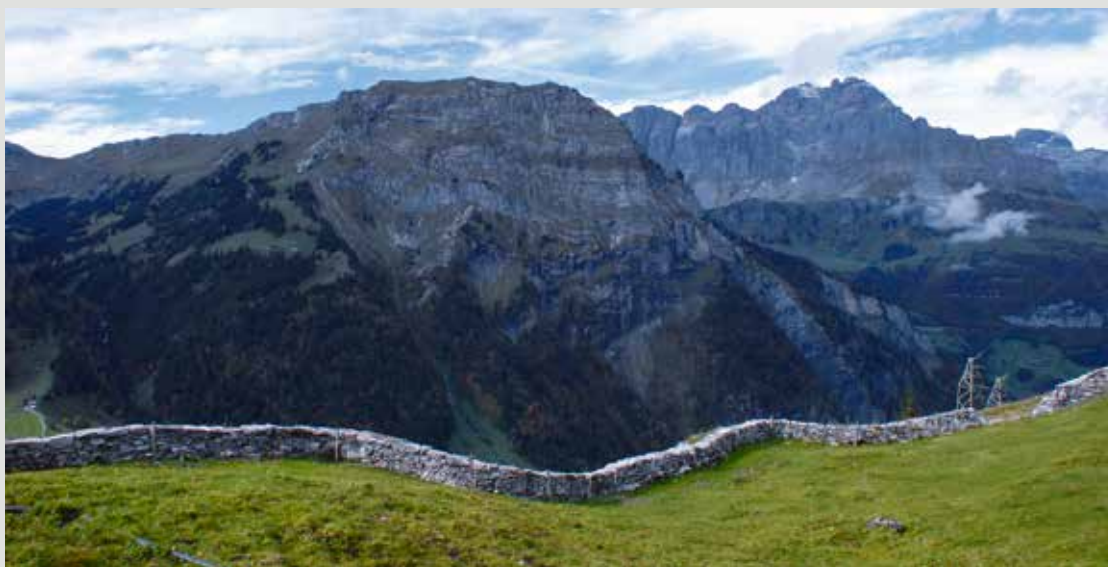
Sanierung der 1 km langen Trockenmauer auf der Baumgartenalp, 800 m über dem Talboden von Linthal GL
