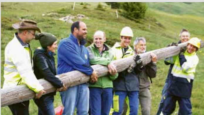
Start zur Erdverlegung der Stromleitungen in der Moorlandschaft auf der Alp Flix
