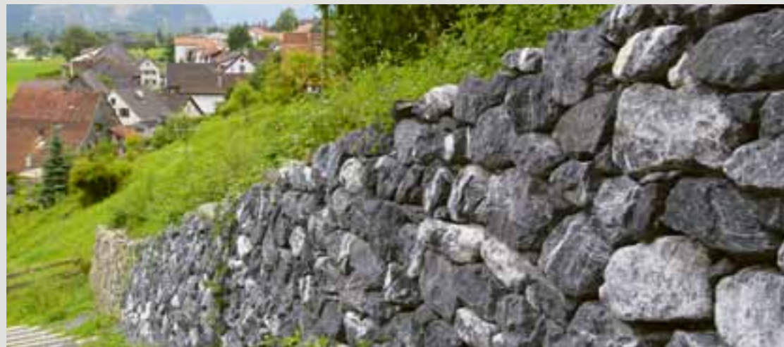
In Wartau SG legt ein Konzept die Prioritäten für die Sanierung der vielen Trockenmauern fest.
