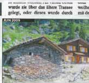
À l'issue des aménagements réalisés au chalet voisin, ainsi qu'à Chénon, la reconstruction de la remise agricole de la Remontiz est enfin terminée, ici avec son nouveau toit de bardeaux.
